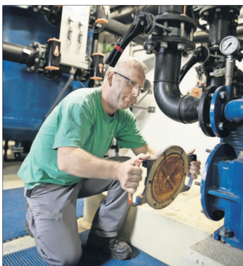
Bahri Tahiri kontrolliert die Filteranlagen unter dem Schwimmbaden.
